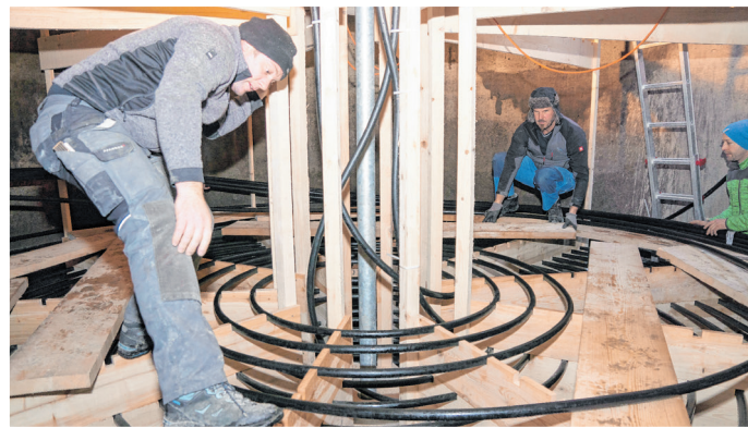
Für das Bürogebäude von Architekt Georg Bechter wurde ein Eispeicher errichtet.
